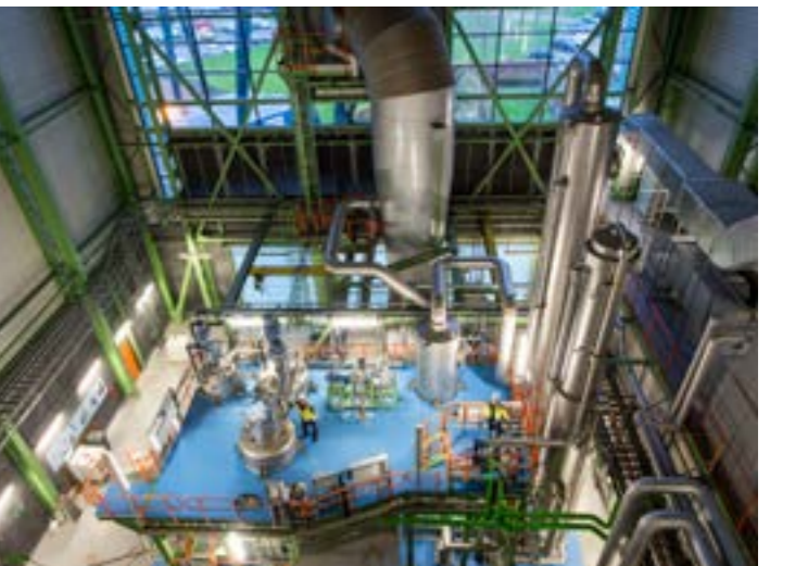
مصنع تجريبي لاحتجاز ثاني أكسيد الكربون واستخدامه في منشأة Twence لتحويل النفايات إلى طاقة. الصورة مهداة من Twence.
