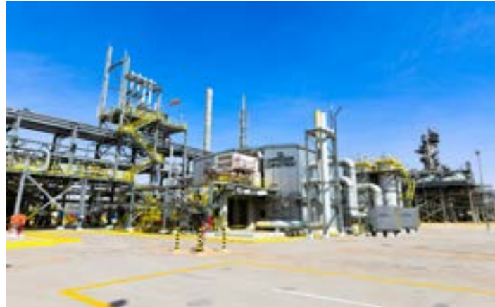
أعلى: منشأة شركة قطر للغاز في راس لفان للغاز الطبيعي المسال. الصورة مهداة من قطر للغاز. أعلى: منشأة غاز الحوية بالمملكة العربية السعودية. الصورة مهداة من أرامكو.
