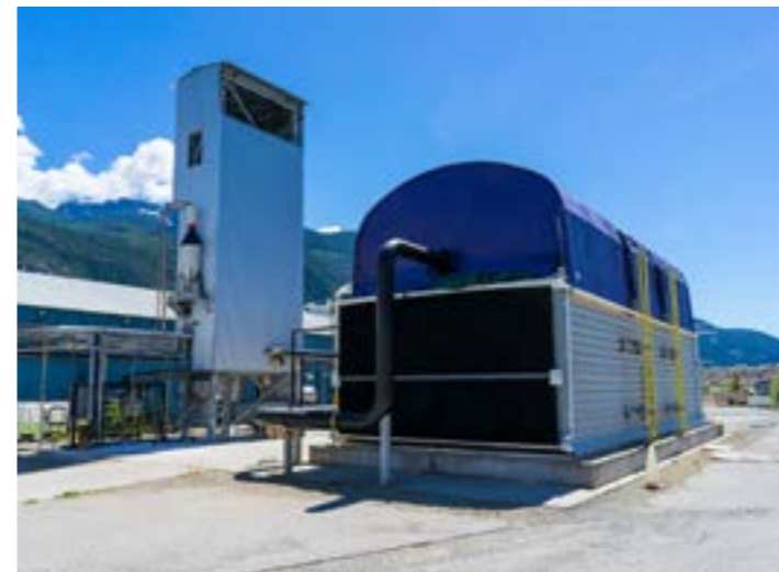
نظام احتجاز ثاني أكسيد الكربون من الهواء مباشرة في المصنع التجريبي التابع لشركة Carbon Engineering. على اليسار تظهر أجهزة ملامسات الهواء والمكلس. الصورة مهداة من شركة Carbon Engineering Ltd.
